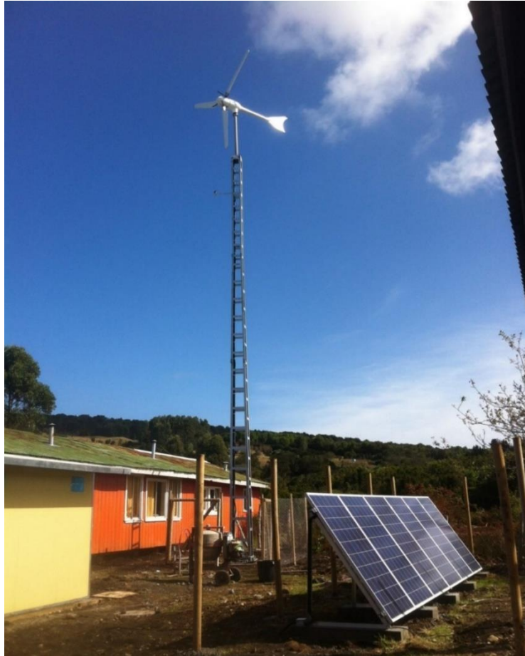
Ilustración 2-6: planta híbrida eólico-solar de 5 [kW] de Escuela Isla Queullín con respaldo de batería, proyectada, construida y fotografiada en 2015 por el autor
